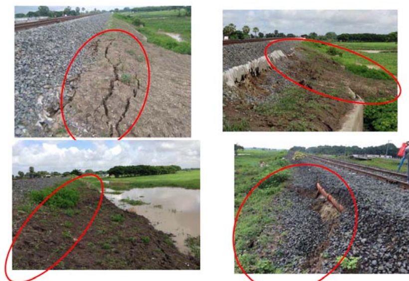
図 7-4-1 斜面の雨季の崩壊状況 (2017 年 7 月 法勾配 1:3)
