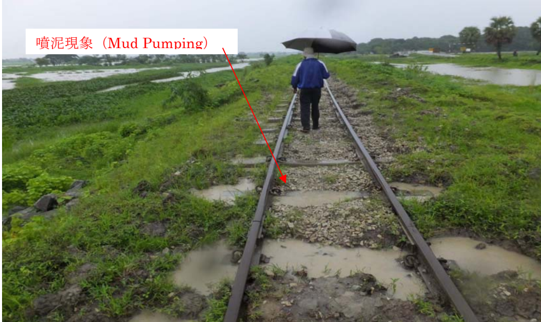
図 4.2-8 エインメの Chaungphyar Site の雨季の状況
