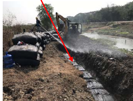
D-Box 及び周辺への散水
