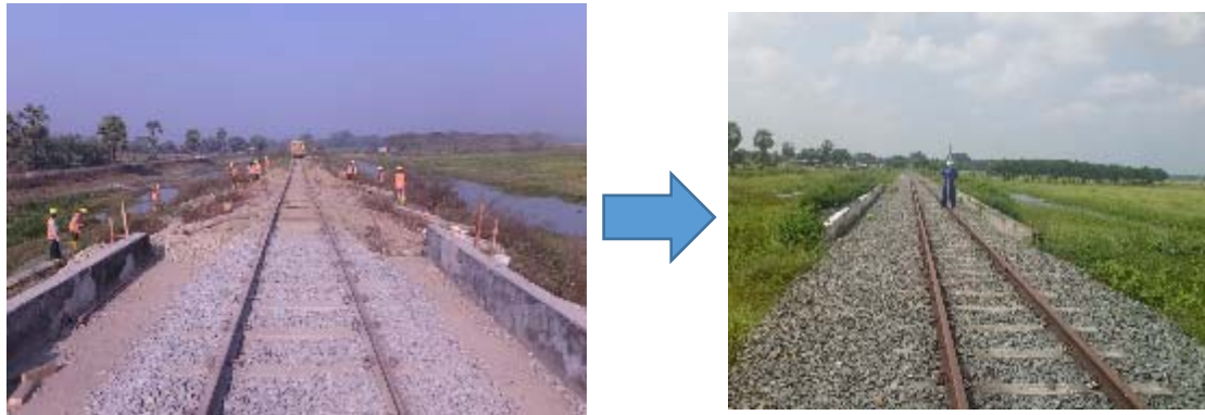
写真-4 バラスト沈下による鉄道軌道部の沈下 (1年間の観測結果より沈下は1~3cm程度)
