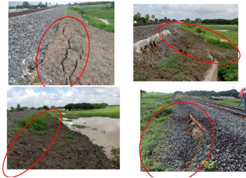
図 3-102 斜面の雨季の崩壊状況（2017 年 7 月 法勾配 1 : 3）
