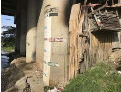
橋の下に刻まれている水位状況を 確認するための目盛り
