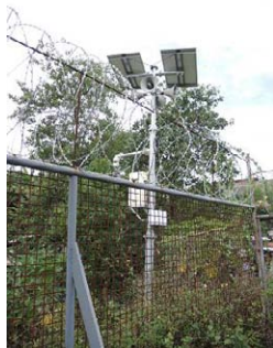
マンダウェ市に設置されている警報装置
