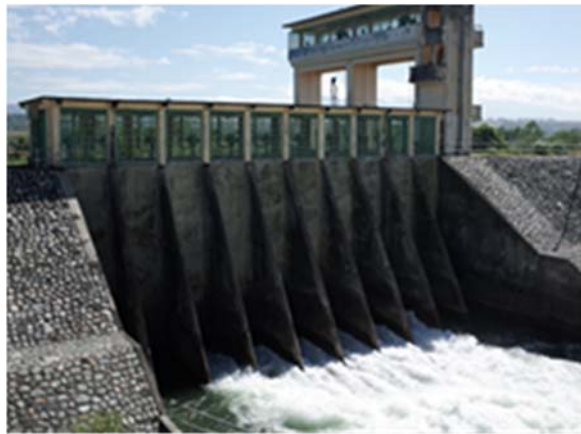
頭首工における取水施設 (スタッフゲージを目視してはかられた水位と HQ カーブから取水量を計算)
