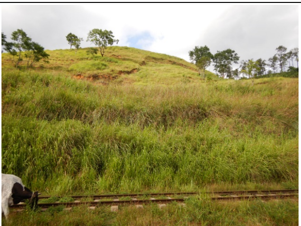
Uduwara 地区の地すべりの滑落崖
