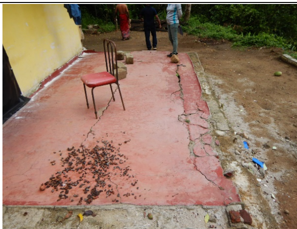
Udamba 地区の家屋に生じた亀裂
