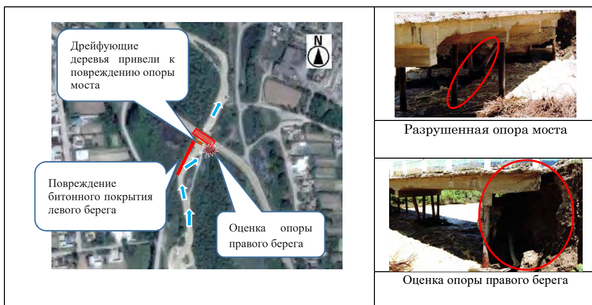
Рисунок 1-2-2 Повреждения моста на реке Урмарал 16 июня 2016 года
