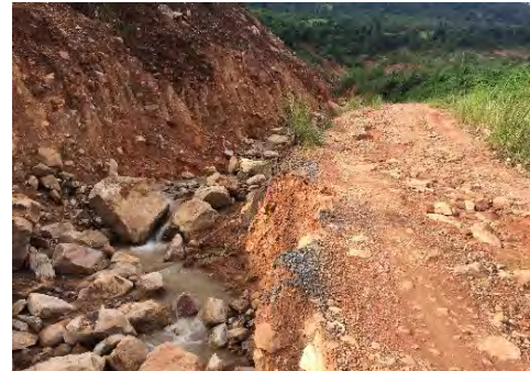
8km 以降は工事の形跡はあるものの、中断された後の数年の雨期で状態は悪化している
