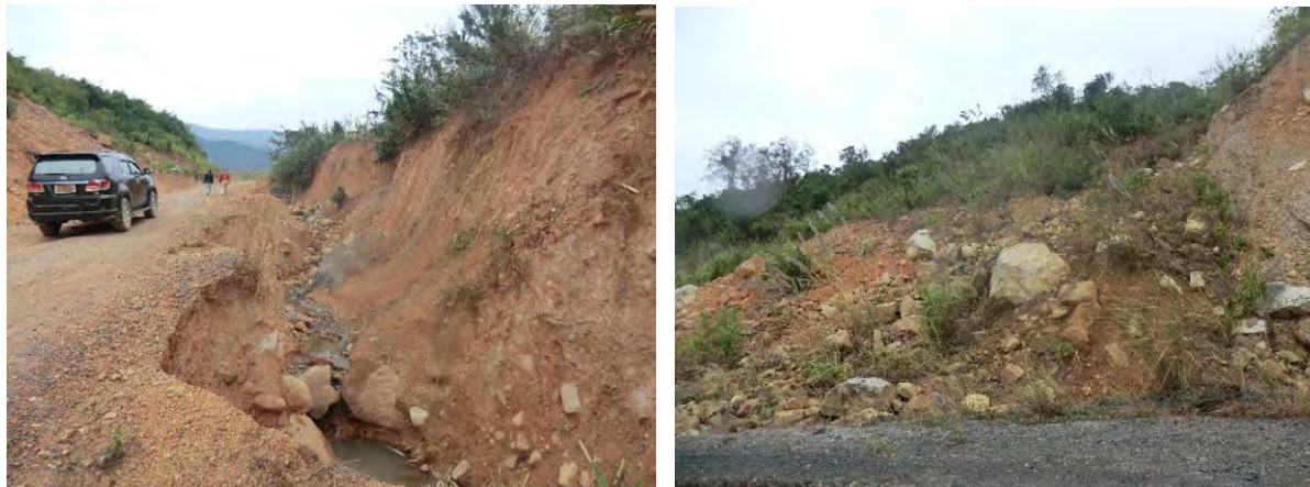
図 5.4.6 山地部現道の顕著な斜面崩壊（プレ F/S ルートの 245KM 付近）
