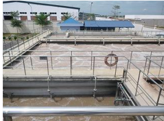
SADO の既存の排水処理施設(2017年2月)
