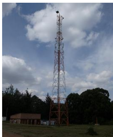
図 1-3 被害の発生している RURA キガリ通信監視塔 (調査団作成)
