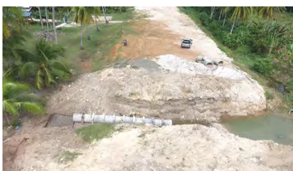
排水路が灌漑水路を横断するための設備 (MC-3 の 0 + 120 地点の排水管) (写真は NIA-PMO の提供)
