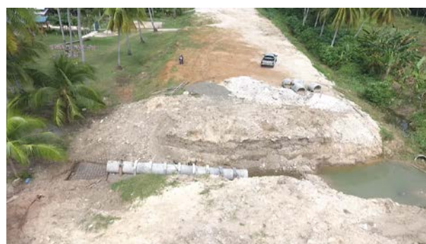
排水路が灌漑水路を横断するための設備 (MC-3 の 0 + 120 地点の排水管) (写真は NIA-PMO の提供)
