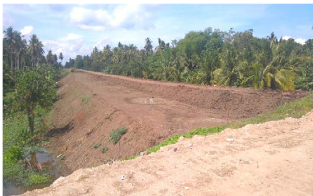
MC-2&MC-3 の分岐地点。この地点の水路堤防の高さは灌漑用水を 22.8km 先まで運ぶため約 8.5m ある。
