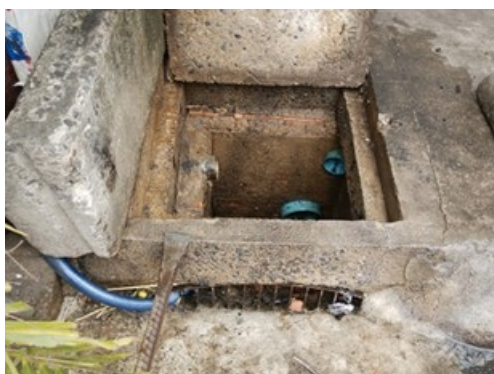
腐敗槽処理水と生活雑排水が流入する污水升
