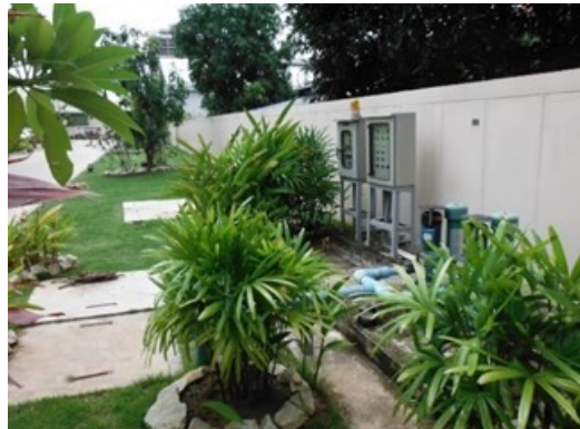
サンライズ病院設置の浄化槽タイプの汚水処理装置
