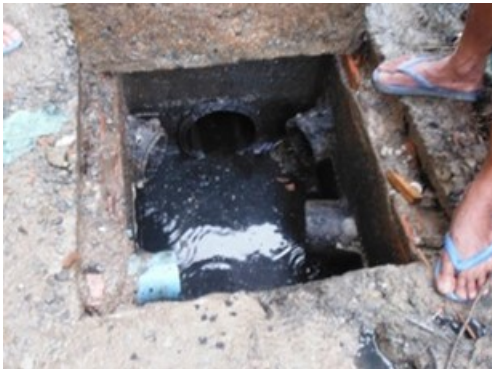
腐敗槽が設けられておらず直接汚水（し尿及び生活雑排水）が流入する汚水升
