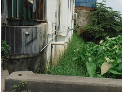
腐敗槽が設けられず直接汚水を排出する家屋
