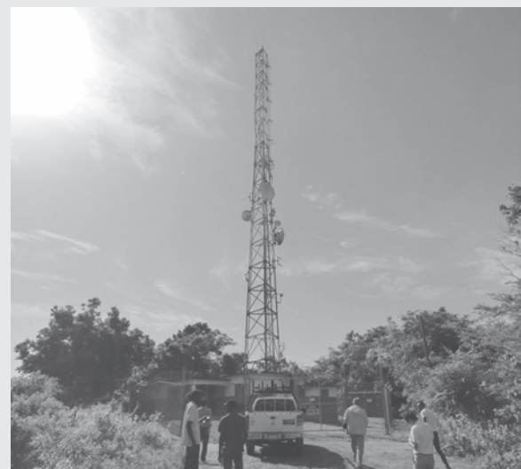
Un pilón sobre el cual se montará una antena de radio digital. Se construirán en total 24 pilones de este tipo en todo el país.
