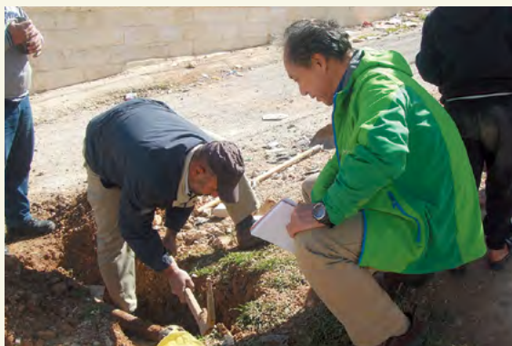
Les responsables de Yarmouk Water Company (YWC) vérifient les fuites des conduites d'eau.
