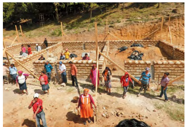
Un projet de construction d'un bâtiment scolaire utilisant des ressources locales. Chacun des 13 groupes communautaires travaillent tous les jours à tour de rôle. Les membres du personnel de l'association municipale au Honduras fournissent des conseils afin que les normes du ministère de l'Éducation soient respectées (Honduras : projet de renforcement des capacités des gouvernements locaux pour le développement régional).
