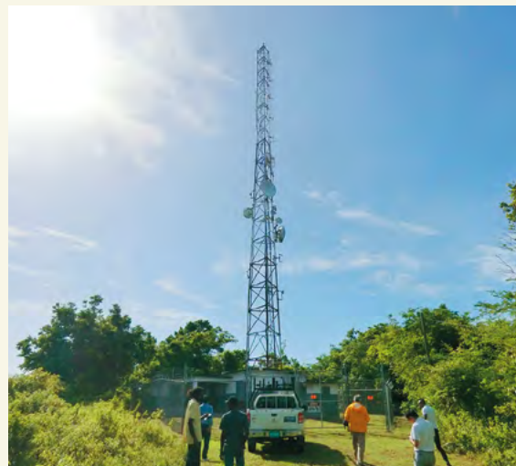
Un pylône sur lequel sera installée une antenne radio numérique. Un total de 24 pylônes de ce type sera construit dans tout le pays.
