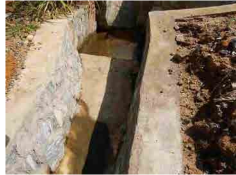
集水柵からの漏水の状況
