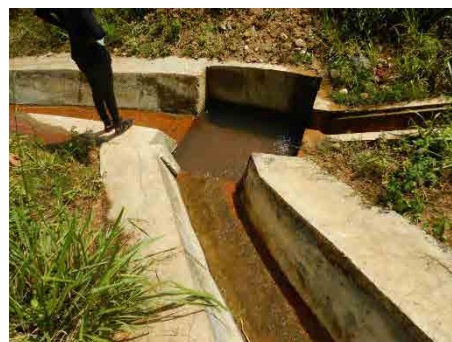
NBRO が定期的に堆砂の除去を実施している。
