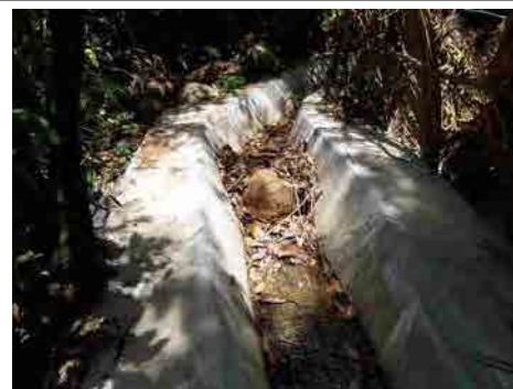
水路に溜まった枯葉等（下流側から）
