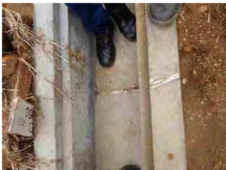
目地の施工不良
