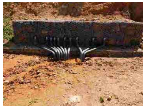
Point No.6 の柵に土砂が流入し埋塞している状況
