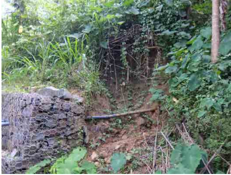
布団カゴ右側の崩壊の状況
