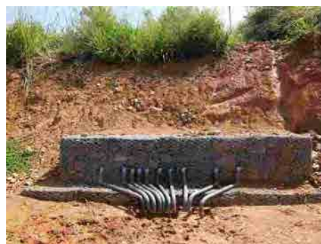
Point No.6 の柵に土砂が流入し ほぼ埋塞している状況
