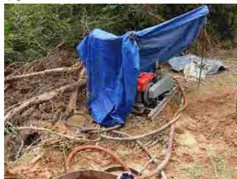
ポンプの使用状況
