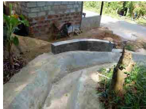
水路の越流箇所
