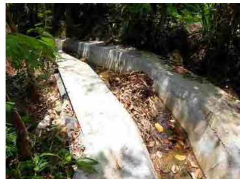
水路に溜まった枯葉等 (上流から)
