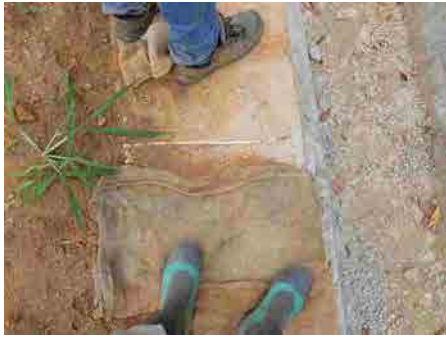
水路工内に放置された捨てコン
