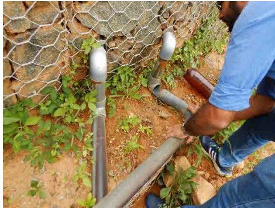
Point6の横ボーリング孔口パイプの破損
