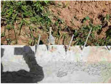
鉄筋の不整配置
