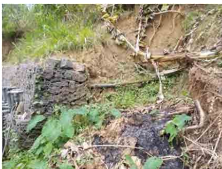
布団カゴ右側の崩壊の状況
