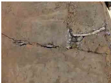
目地の施工不良
