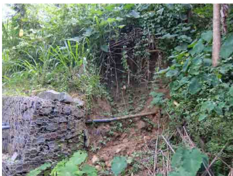
布団カゴ右側の崩壊の状況
