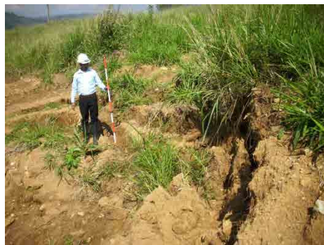
Point 1 背後斜面の段差
