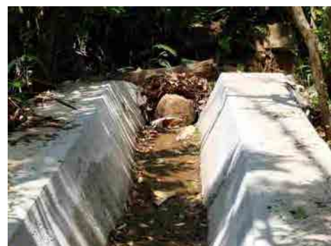
水路に溜まった枯葉等 (下流から)
