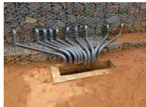
Point No.6 の柵に土砂が流入している状況
