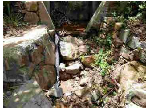
枿下部のコンクリート打設が実施されていない箇所
