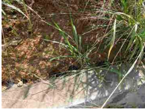
上部斜面における水路側部の侵食状況
