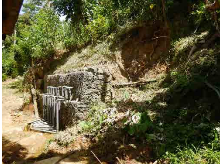
布団カゴ右側の崩壊の状況
