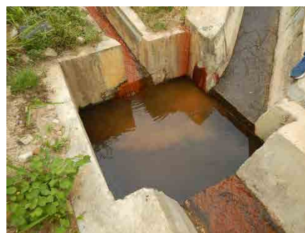
NBRO が定期的に堆砂の除去を実施している。
