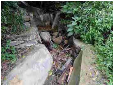
樹下部のコンクリート打設が実施されていない箇所と流木等による閉塞状況
