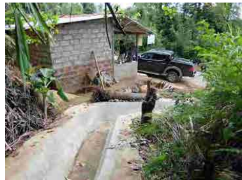
水路の越流箇所
