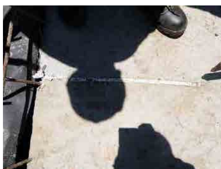
目地の施工不良
