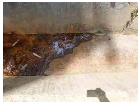
水路の漏水箇所
