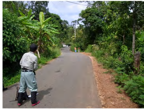
地すべり活動による道路の段差
