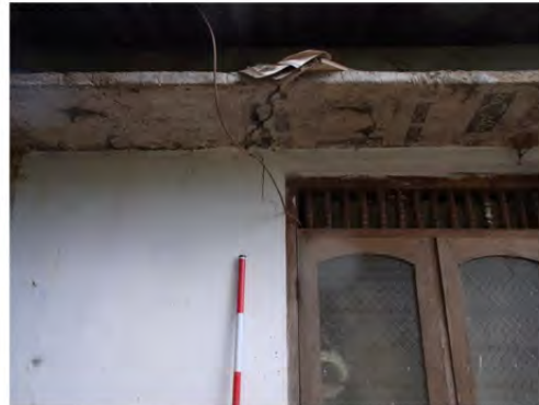
地すべり活動により民家壁に発生した亀裂
