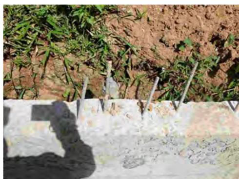
鉄筋の不整配置
