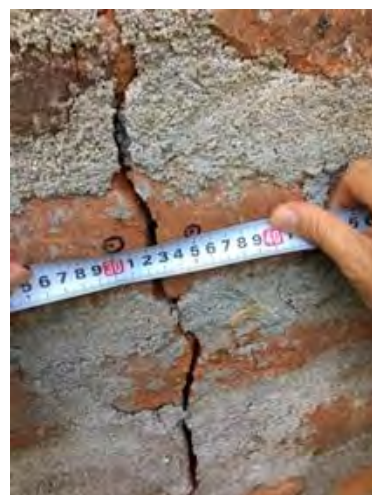
図 5.7 2016年5月民家に発生した クラックの状況
