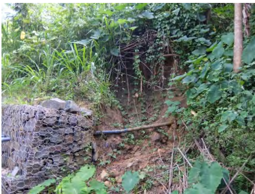
図 5.8 水平ボーリング孔周辺の崩壊
