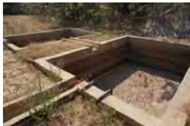
ニャンウーの Taung Ba 村の中核農家の圃場に設置された集水池
