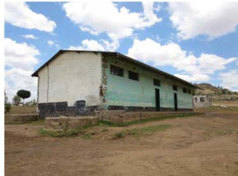
E2/Motsekuoa 既存校舎の内、6 棟は老朽化が著しく、危険な状態である。
