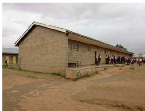
E1/Abia 構内はバリアフリーとなっていない。
