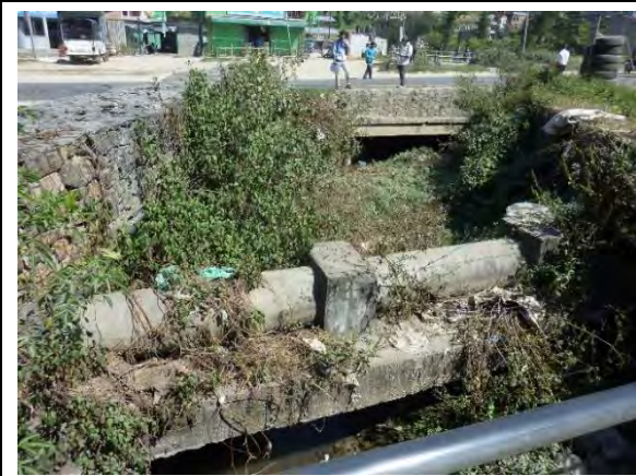
写真-19: バネパ市街地ドゥリケル側の既存橋梁 (施工後 40 数余年が経ち老朽化が進み、破損が目立った既設橋梁と下水橋)
