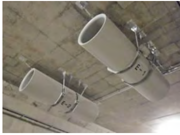
排煙設備（ジェットファン）
