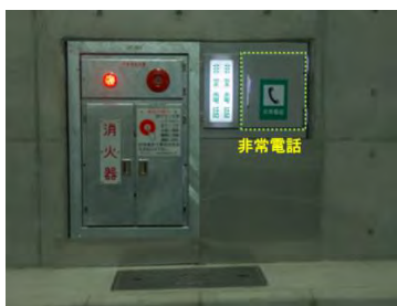
非常用電話（壁面設置）
