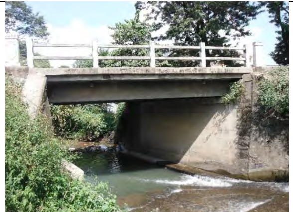
写真-10 : ジャガテイ市街地終点部の既存橋梁 (施工後40 数余年が経ち老朽化が進み、破損 が目立っている)
