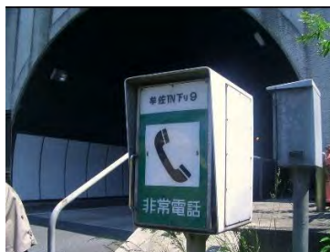
非常電話（トンネル坑口部）
