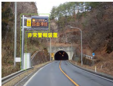
非常警報装置
