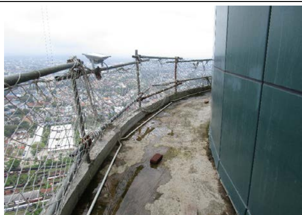
マイクロ設備プラットフォーム（パラボラアンテナ設置予定箇所）
