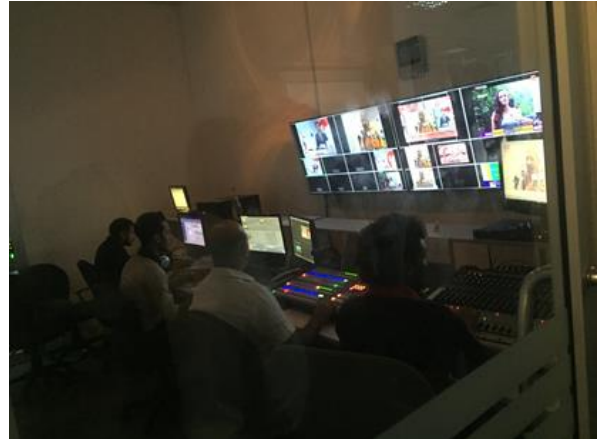
コントロール設備 (Derana TV)
