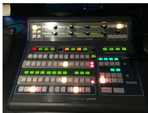
マスターコントロール設備 (CSN)
