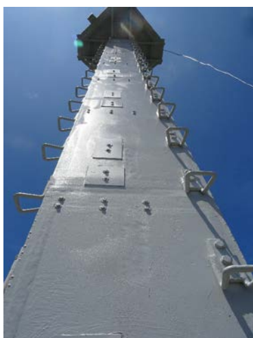
アンテナ取付部
