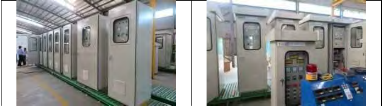
Electrical panels အားစကုရုံတငြစုဆေးပျခငး (၂၀၁၅ နိုဝငးဘာ ၂၂)
