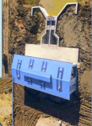
Lift Pumping Station တည်ဆောက်ခြင်း လုပ်ငန်းဆောင်ရွက်နေပုံ
