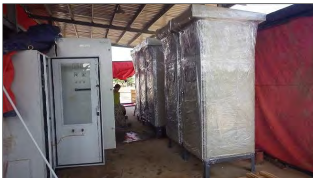
制御盤 (2016年6月2日)
