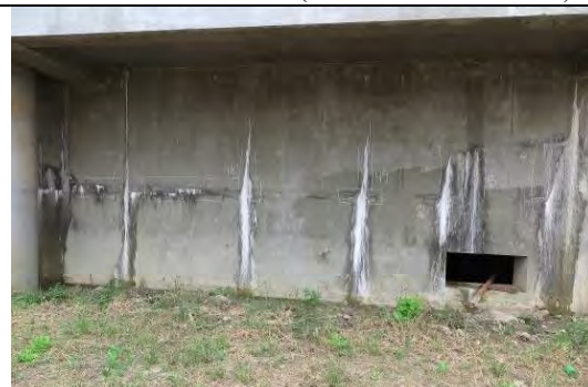
沈殿池の漏水調査 (2016年12月7日)
