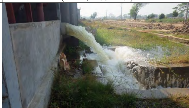
ろ過池からの排水 (2018年3月13日)
