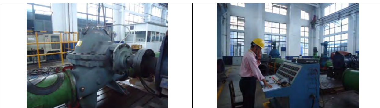
工場検査：揚水ポンプ (2015年7月9日)
