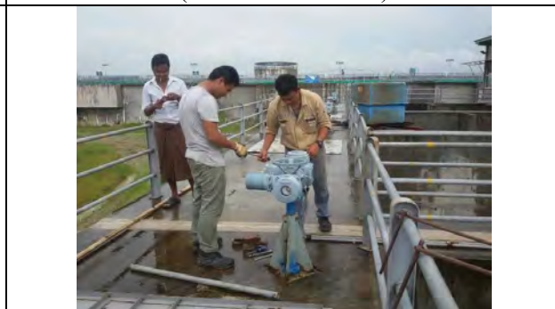
ろ過池の排水弁の故障の発見 (2017年7月28日)
