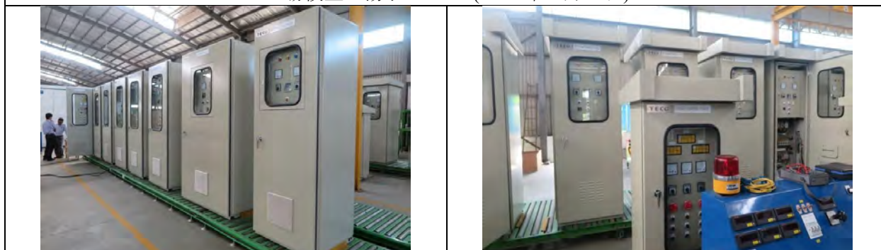
工場検査：配電盤 (2015年11月22日)
