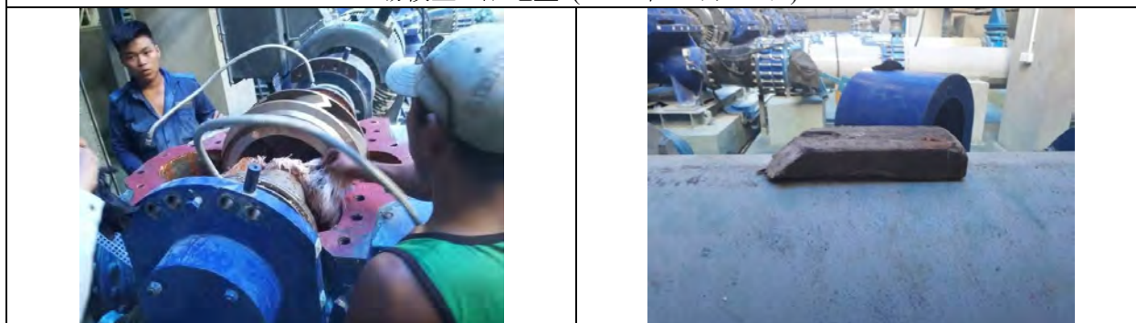
揚水ポンプから見つかったビニルバッグ (2017年5月16日)
