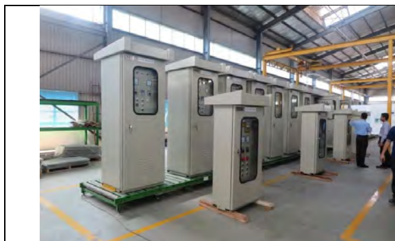
工場検査：配電盤、逆洗ポンプ盤、およびブロワ盤 (2015年11月22日)
