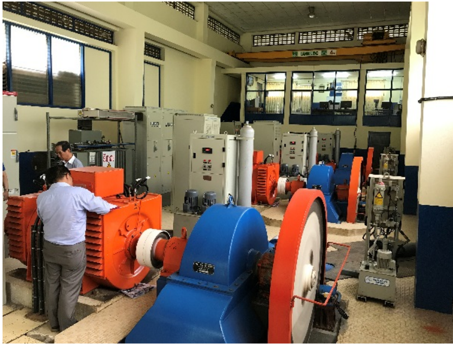
Nam Dong 発電所全景
