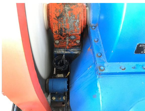
目視確認箇所確認 軸受油面
