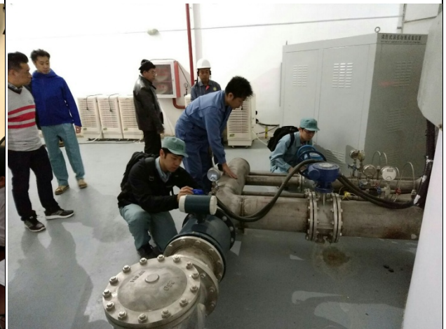
Nam Khan 2 冷却水配管センサー取付調査
