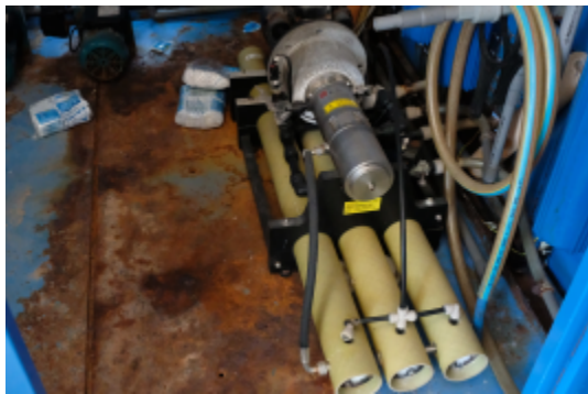
セラヤベサラ島の使用不能海水淡水化装置
