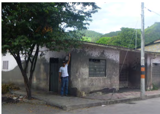
Imagen No. 2.29. Efectos del evento hidrogeomorfológico del 18 de abril de 2011: Huella de crecida en vivienda (de hasta 2,25 m).
