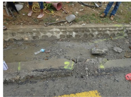
③ 側溝に生じた亀裂
