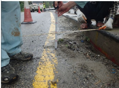
② 路面の沈下（約18cm）
