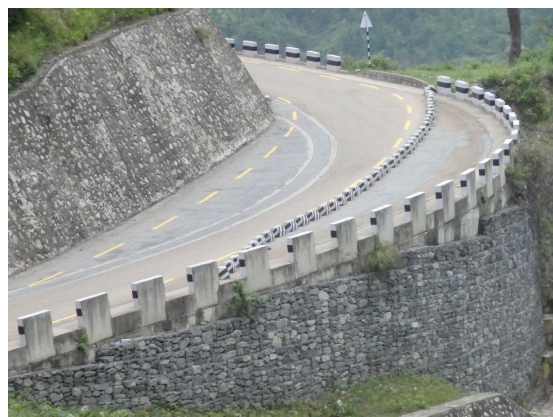
写真-8 Sta.33+695 の状況 ガビオン擁壁が谷側に倒れ込んでいる。
