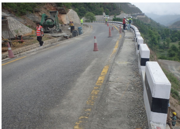
写真-9 Sta.11+620 の状況 路面の沈下が認められる。
