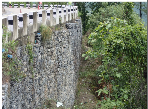
写真-6 33+440 の状況 ガビオン擁壁が谷側に倒れ込んでいる。
