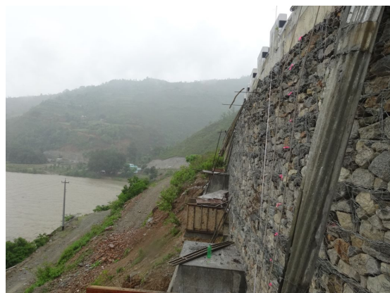
写真-10 Sta. 11+620 の状況 ガビオン擁壁が谷側へ倒れ込んでいる。
