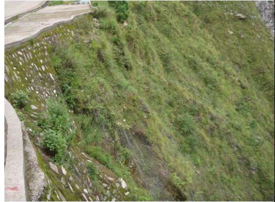
写真-2 Sta.17+400 の状況 侵食が進行している。
