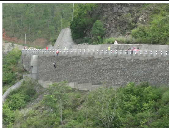
写真-12 Sta.15+520 の状況 ガビオン擁壁が谷側へ倒れ込んでいる。
