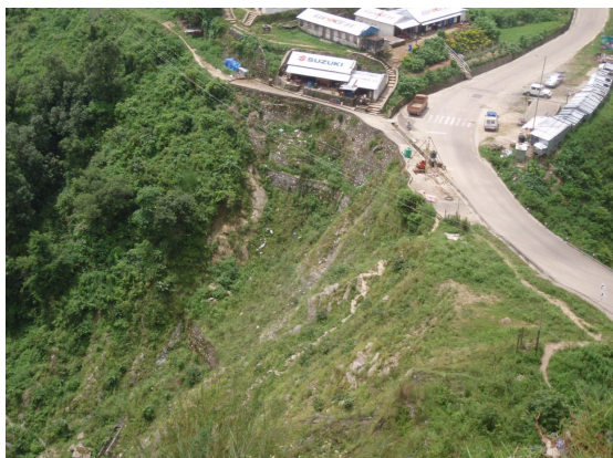
写真-1 Sta.17+400 の状況 崩壊が徐々に拡大している。
