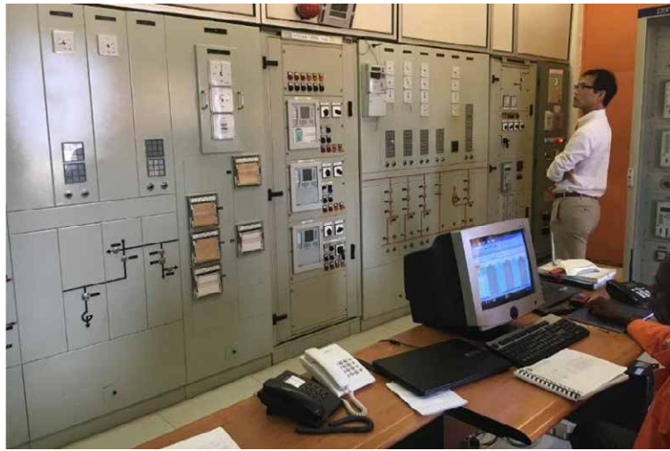
Nampula220 変電所 制御室
