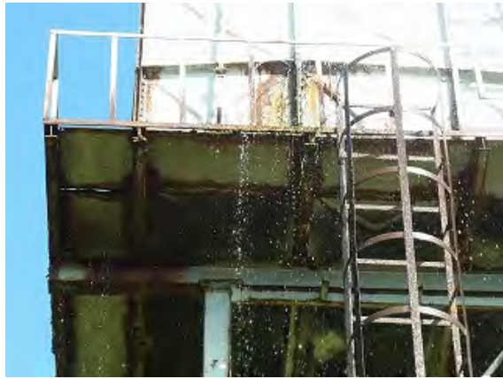
Itula 管路給水施設の高架式貯水槽。老朽化により漏水が生じている。架台部および梯子が錆により腐食し、崩壊の危険性がある。 (Moyo 県 Itula 郡)
