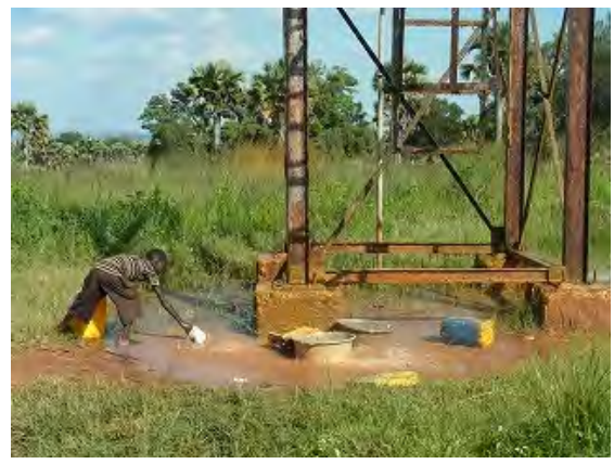
Itula 管路給水施設の高架式貯水槽。住民が漏水により地面に溜まった水を取水する様子。 (Moyo 県 Itula 郡)
