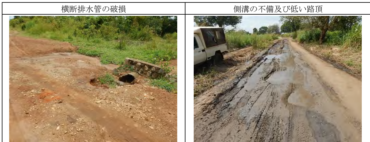
写真 6.3-1 排水施設の維持管理が不十分な事例
