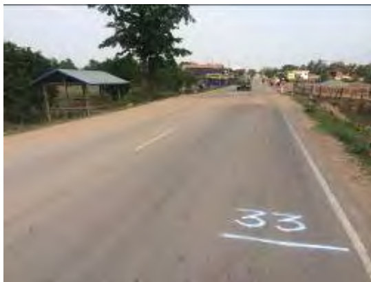
轍ぼれが進行した損傷
