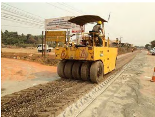
タイヤローラーによる一次コンパクション
