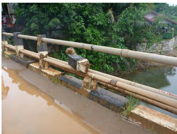
ガードレール
