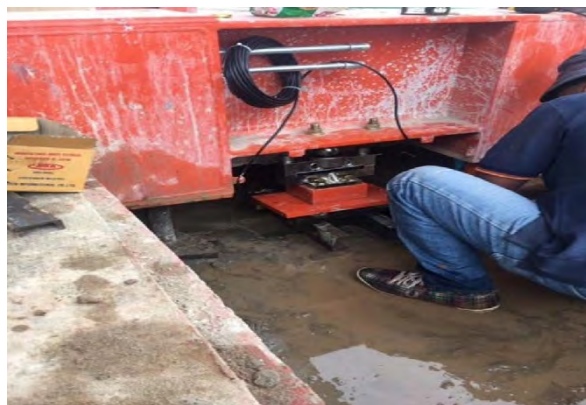
計測用セル設置
