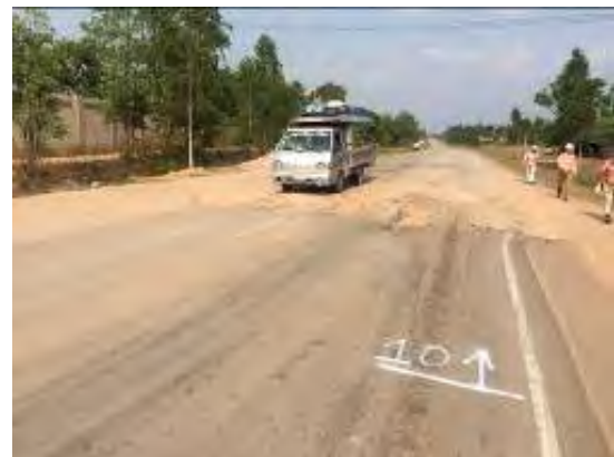
路床からの損傷
