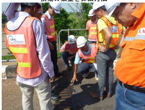
エクステンションジョインの点検 出典：JICA 専門家チーム
