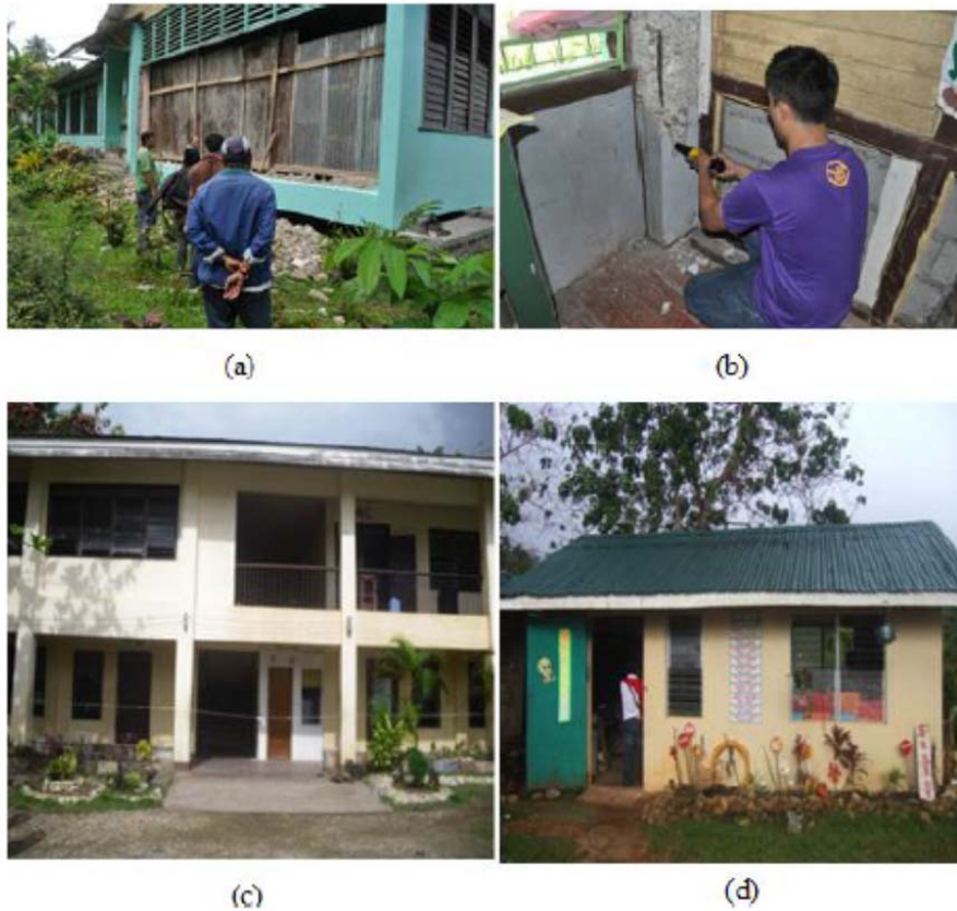
図 3-20 2012 年ネグロス島沖地震によって損傷した公立学校建築物の評価
