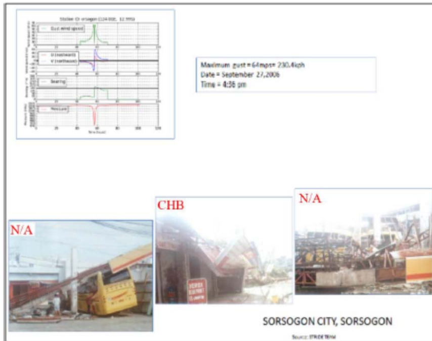
図 3-7 ミレニオ台風の際の Sorsogon City における損傷写真
