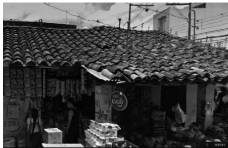
サンタクルス住宅-素焼き瓦の屋根で破損しやすい
