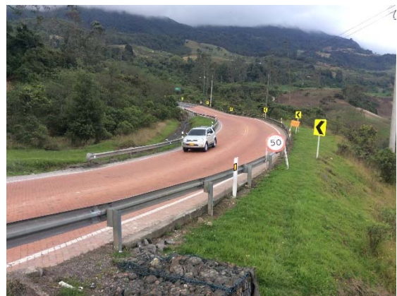
写真6 地すべりの痕跡と補修跡
