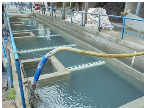
写真-1.2 工事排水処理施設
