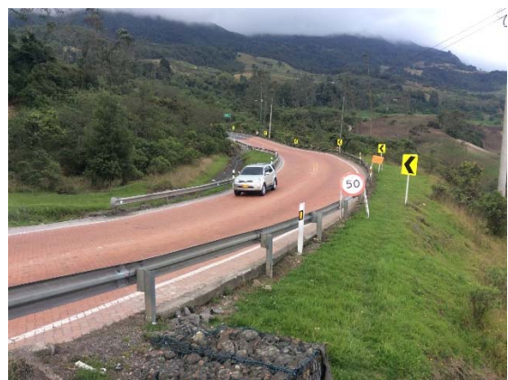
写真6 地すべりの痕跡と補修跡
