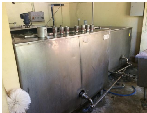
冷蔵設備(冷蔵センター)
