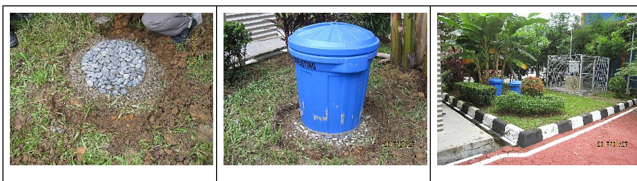
底部に玉砂利を敷き、ごみ箱を改造した直置きコンポスターを設置（2017 年 1 月 26 日）
