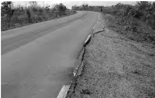
Dommages sur les bordures du corridor central au Togo
