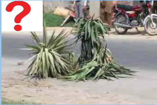
Manhole Lid Missing
