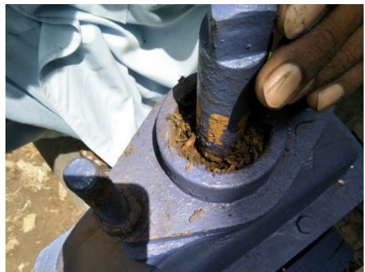
写真 3.17 原型が確認できない程、劣化した仕切弁のグランドパッキン
