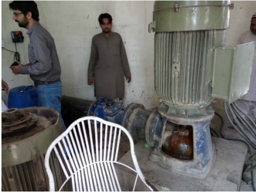
写真 3.26 ポンプ始動時におけるポンプ軸受の焼き付き防止のための潤滑水供給不可
