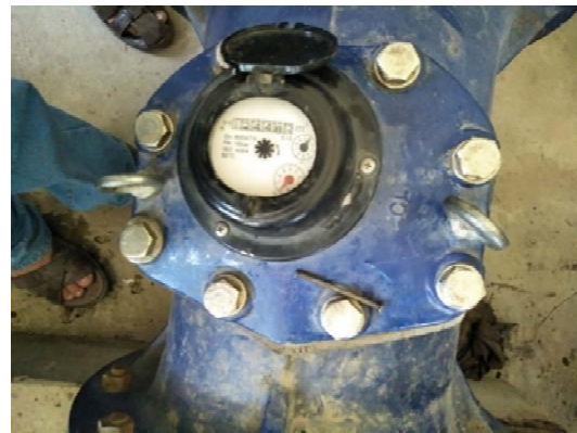
写真 3.29 機械式流量計と超音波流量計による流量比較により、ほぼ同量と考えられる 1% 程度の違いを確認
