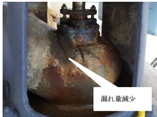
写真 3.23 グランドパッキン交換により、減少した漏れ
