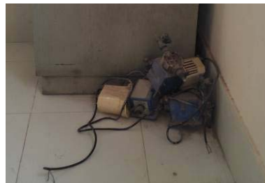
写真6.5 収集された修理を必要とする塩素注入器
