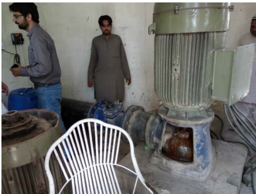
写真 3.30 錆、腐食が著しい設備
