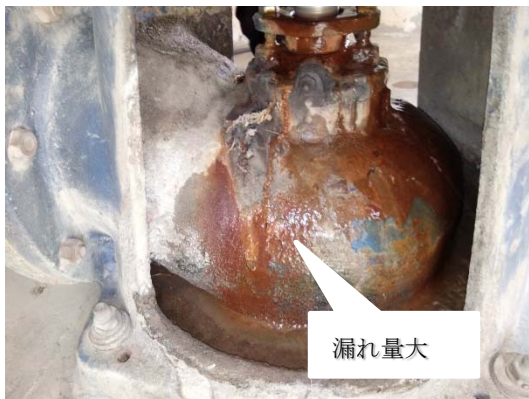
写真 3.22 消耗品であるグランドパッキンを交換しないと、ポンプグランド部から漏れが発生する。その漏れは、腐食やポンプ性能低下の原因になる。
