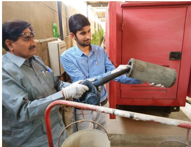
写真 2.8 ブロアを用いた発電機のエアフィルター清掃演習
