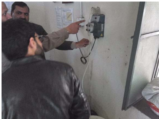
写真 4.5 塩素注入装置
