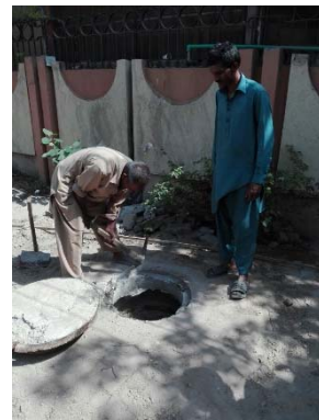
地表面までかさ上げされたマンホール蓋
