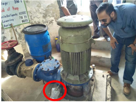
写真 3.20 ほとんどの井戸ポンプで圧力計は設置されていない
