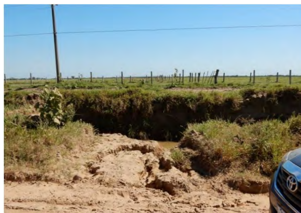
既存水路の損傷
