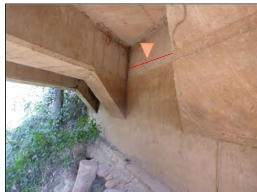
最高水位の跡（A2 橋台）
