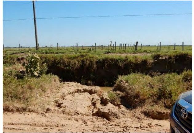
既存水路の損傷
