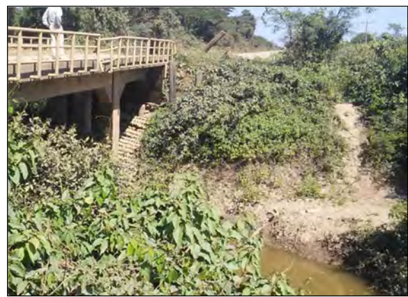
既設護岸洗掘状況
