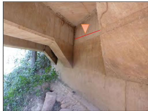
最高水位の跡 (A2 橋台)
