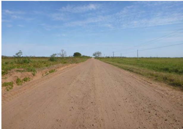
砕石が転圧されて比較的状态が良い
