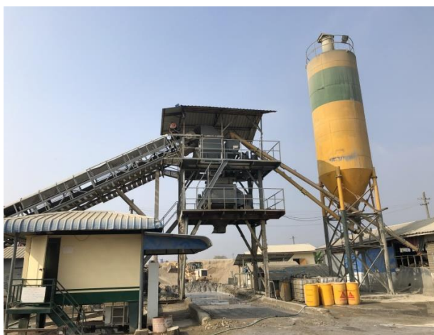
写真 25 生コンクリート・プラント
