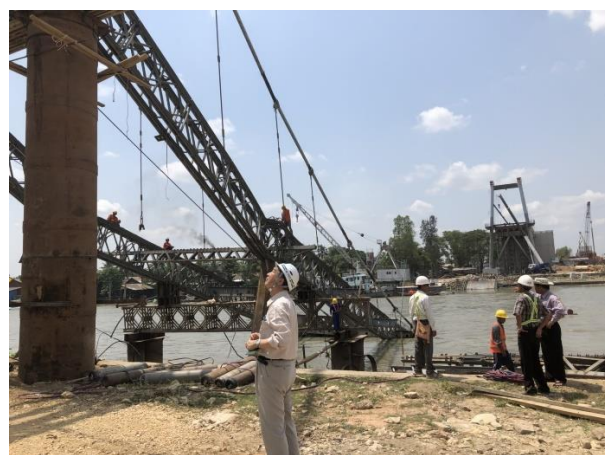
写真8 Myaungmya 橋の落橋状況2
