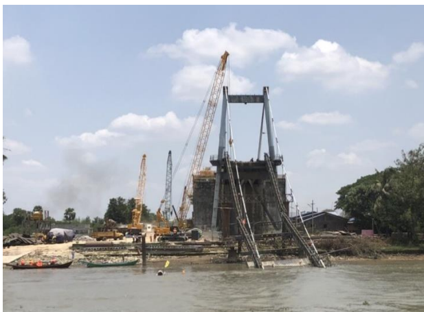
写真7 Myaungmya 橋の落橋状況1
