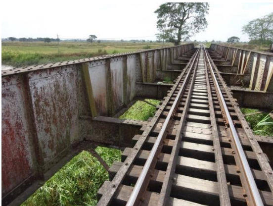
ヤンゴン・マンダレー鉄道の老朽化した橋梁
