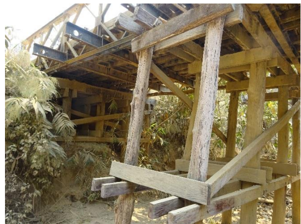
写真 32 ザガイン地域の橋梁老朽化2
