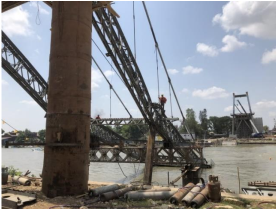
Myaungmya 橋の落橋状況
