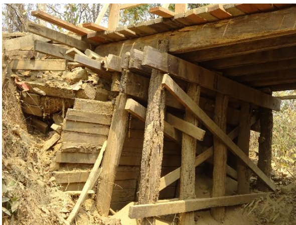
写真 31 ザガイン地域の橋梁老朽化1
