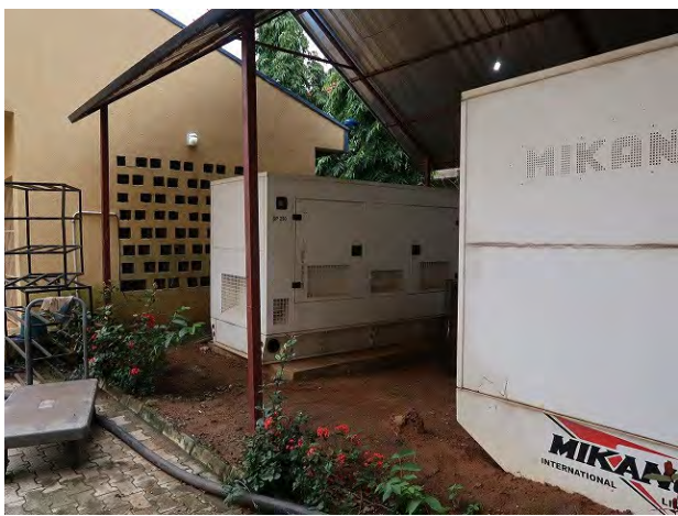
既存非常用発電機。NRL ではディーゼル発電機 3 台と自動電圧調整器を設置している。商用電力網の停電、電圧変動対策が重要となる。
