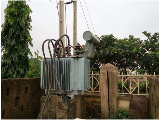
屋外型の既存変圧器 500KVA。引込み電圧 33kV から 415V へ降圧している。
