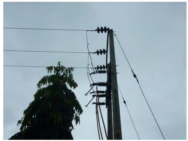
33kV 中圧配電網の引き込み電柱。断路器の設置、立ち下げ配線、新設中圧受電盤（日本側供与）への接続は先方負担工事。
