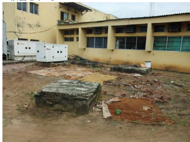
写真 1 7 CPHL 非常用発電機および浄化槽群。NRL 同様に 2 層式で場内浸透処理を行っている。
