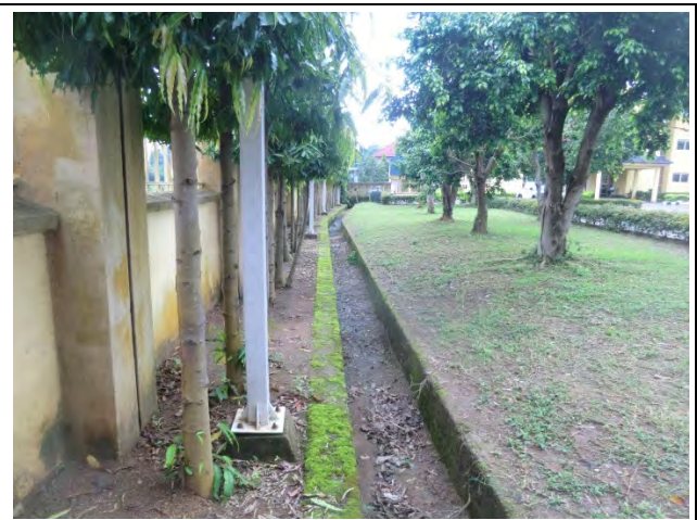
場内の雨水排水側溝。敷地境界線内側に沿って構内四辺に設置されている。
