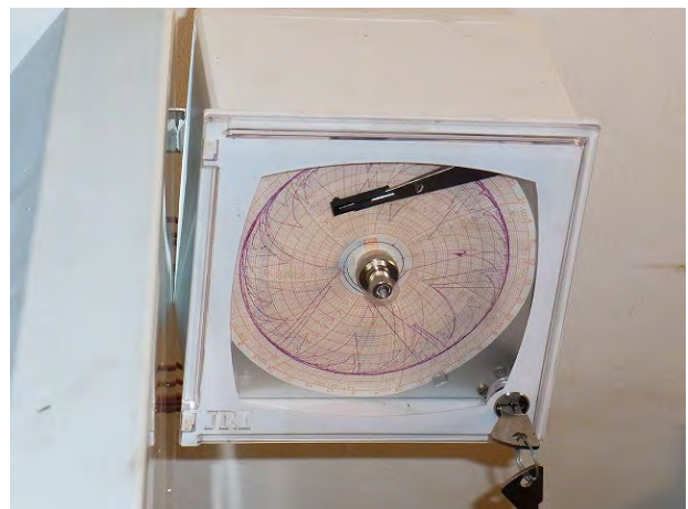
写真12 検体保管室内のフリーザーについている温度記録計。記録データから停電時のフリーザーの停止が確認された。フリーザー内の冷凍・冷蔵不備が伺え保管物の品質・安全性が危惧される。非常用電源に接続されていないことが要因と考えられる。
