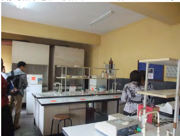
写真 1 5 CPHL ウイルス学検査室内部。機械換気設備はなく窓開口による自然換気のみ。前室、手洗器の設置もない。
