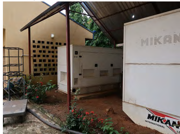
写真6 既存非常用発電機。NRL ではディーゼル発電機 3 台と自動電圧調整器を設置している。商用電力網の停電、電圧変動対策が重要となる。
