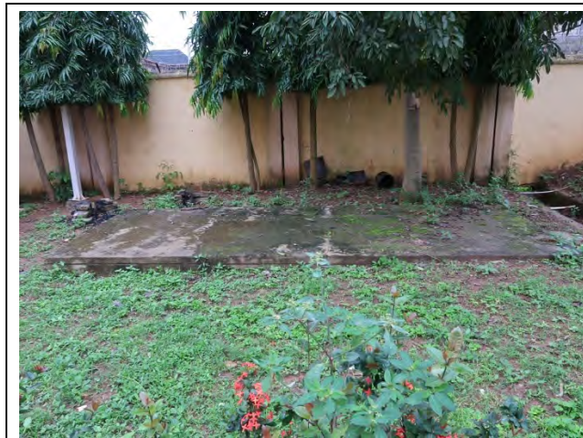
地中埋設型の浄化槽。腐敗槽、沈殿槽の 2 槽式で処理水は場内で地中浸透としている。
