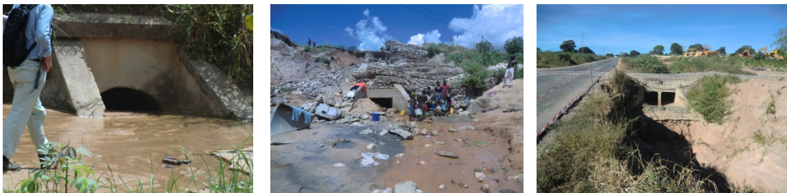
容量不足のカルバート (鉄道) 容量不足のカルバート(道路) カルバート流末の浸食 (鉄道)
