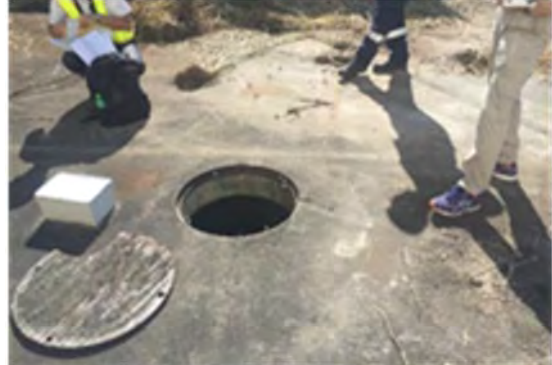
写真 32 雨水タンク マンホール
