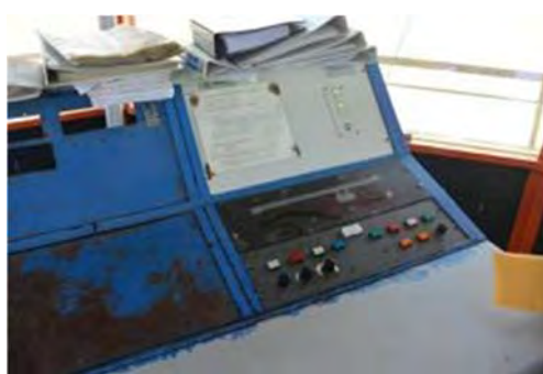
写真 10 管制塔内航空灯火コンソール
