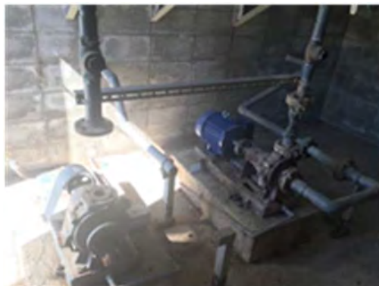
写真 30 井戸送水ポンプ
