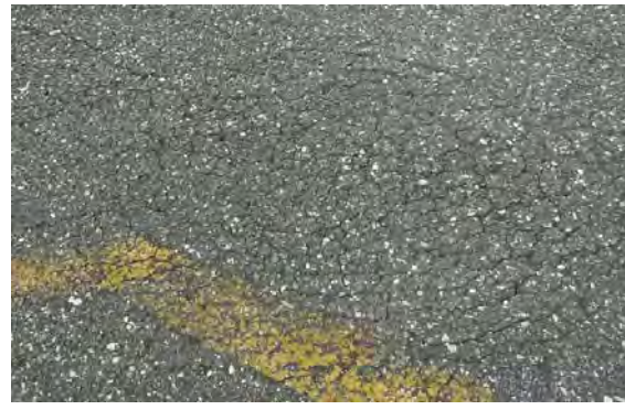
写真8 国際線エプロンの舗装 亀甲状クラックが発生している
