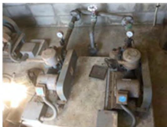
写真 38 故障しているブローア
