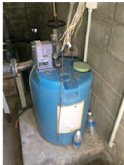
写真 36 ポンプ内塩素滅菌ユニット
