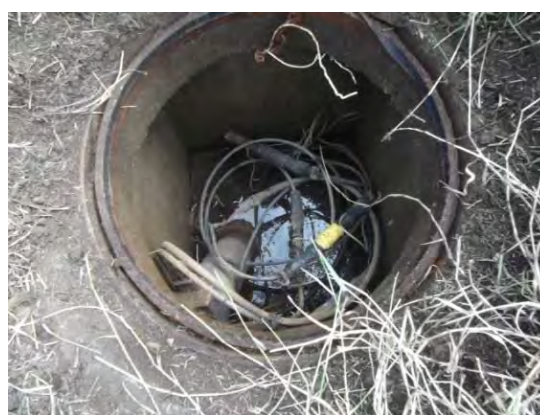
写真5 誘導路端灯のハンドホール (蓋がある物の内部)
