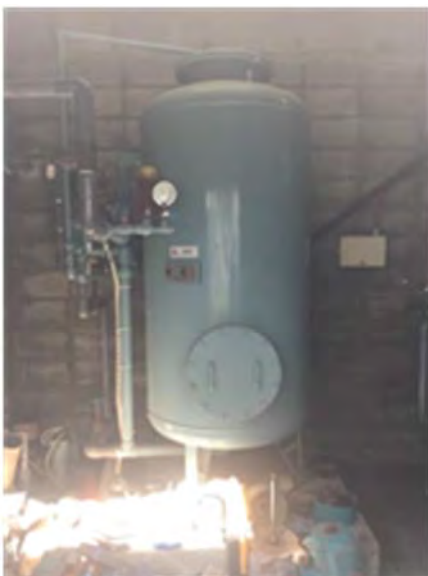
写真 35 ポンプ内ろ過ユニット
