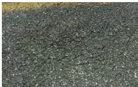
写真2 国際線エプロンの アリゲータークラック (ユニット2)
