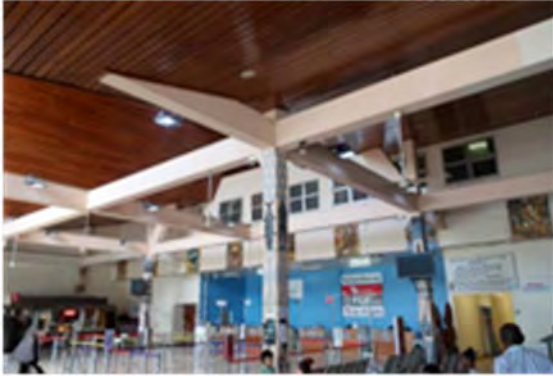
写真 43 チェックインホール照明
