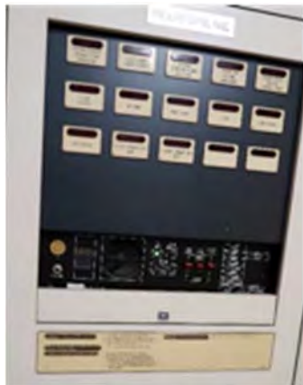
写真 47 自動火災報知受信機
