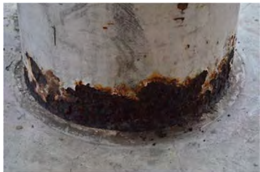
写真 25 エアサイドの柱根元の錆(1)
