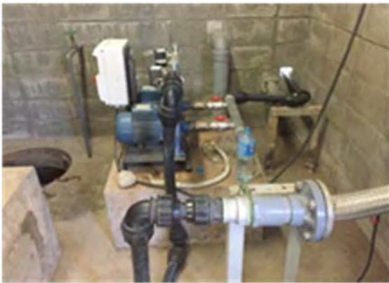
写真 33 給水ポンプユニット
