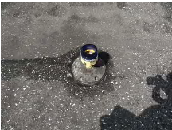
写真11 航空灯火 カバーが欠損したままの状態の巡回灯
