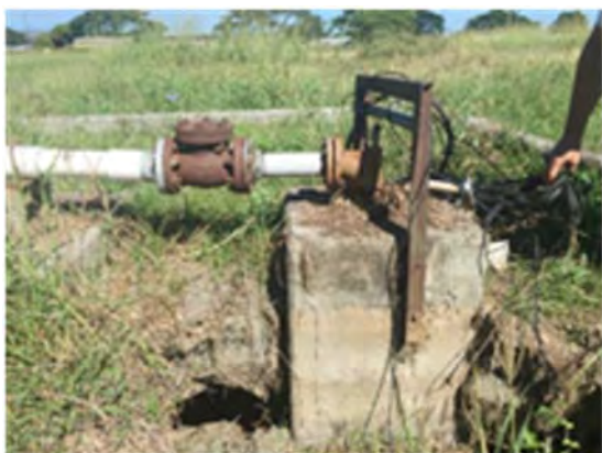
写真 29 深井戸ポンプ
