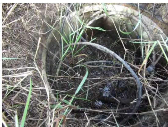
写真4 誘導路端灯のハンドホール (蓋がない物の内部)
