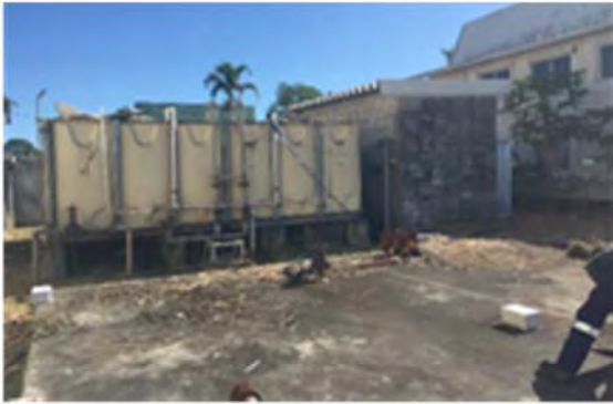
写真 31 給水設備全景
