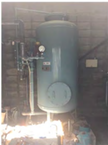
写真 35 ポンプ内ろ過ユニット
