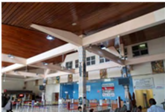
写真 43 チェックインホール照明
