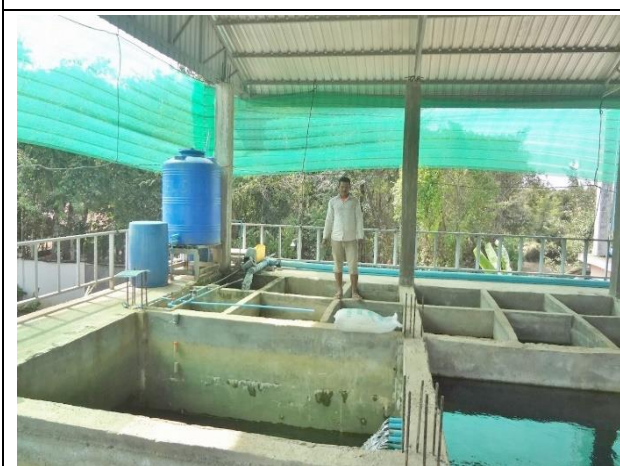
民営水道②浄水場施設
