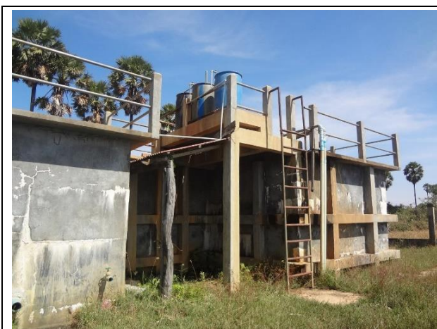
民営水道①浄水場施設 Kraing Chek Water Supply
