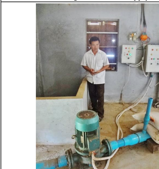
民営水道①ポンプ室
