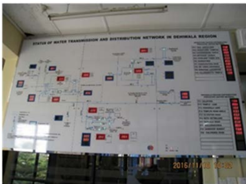
オンラインで表示される送・配水管の水圧モニタリングボード、配水管水圧：-0.6m~12.9m まで示す（於：西部州南部 RSC、Dehiwala 給水区）
