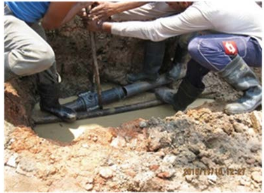
施工現場。芯出し・面取りせずに、ゴムパッキン付継手で配水管切管部を接合（於：Dehiwala 給水区）
