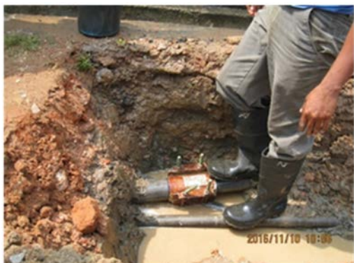
漏水工事の様子。護岸工事に伴う重量車通過時に埋戻土中の石片が配水管を損傷して漏水(於：Dehiwala地区)
