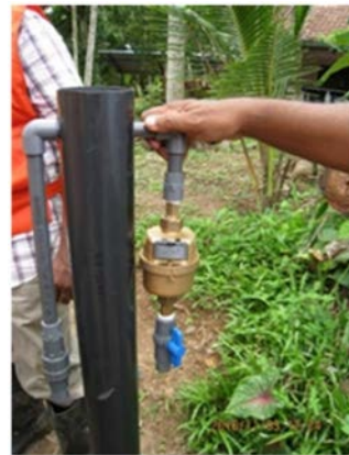
顧客メータの設置個所、宅地内に設置(於：南部州RSCの給水地域)
