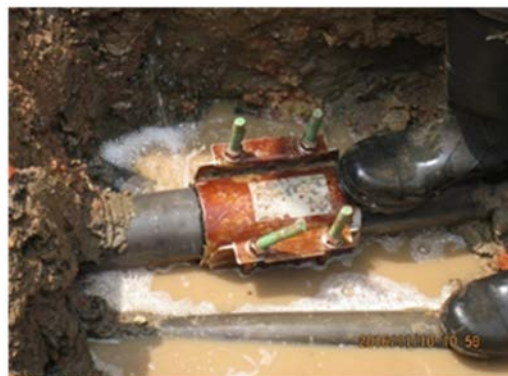
クランプによる修理箇所の脇で漏水が発生(於：Dehiwala地区)
